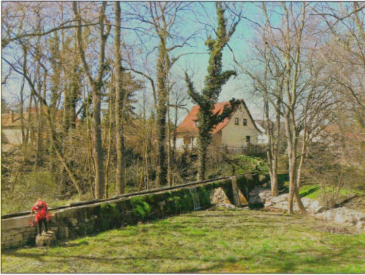
Bild 4-09 Das Wasserkreuz in Magdala – das Bauwerk überstand Starkregenzeiten, Eisgang, Frost, Sommergewitter und Strömung auch wegen ausreichender Durchlasshöhe.
